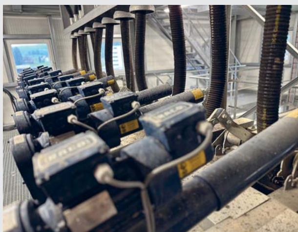
... und deren Verteilsteuerung.
